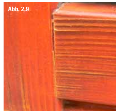
Feuchtigkeitsschaden durch aufgerissene Holzverbindung
