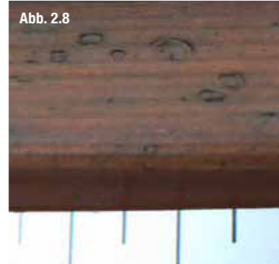
Von Bläuepilz befallene Oberfläche (infolge von Hagelschlag)
